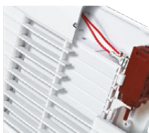
Wentylator nie pracuje – żaluzja jest zamknięta
